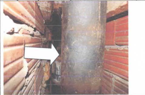
Сл.бр.45. Гусана цев у „Техничком каналу“
