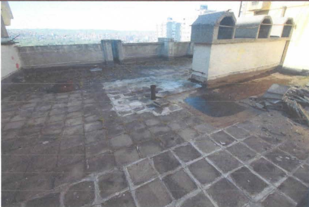
Сл.бр.18. Започети на прекинати санациони радови на кровној површини зграде у делу изнад стана бр. 47, код вентилационе и канализационе цеви управо на оном месту где се појављује влага на зидовима и плафонима стана бр. 47, који припада Предлагачу.
