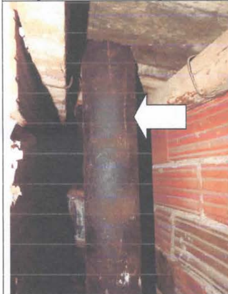
Сл.бр.42. Гусана цев у „Техничком каналу“
