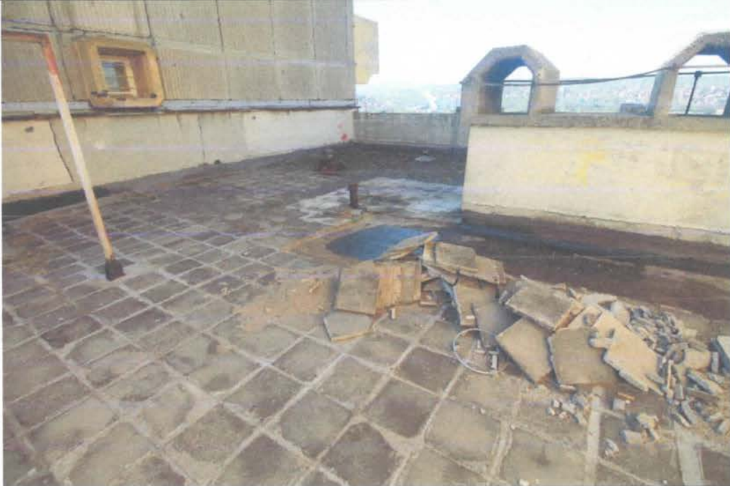
Сл.бр.20. Започети на прекинути санациони радови на кровној површини зграде изнад стана 47
