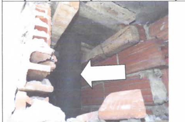
Сл.бр.44. Гусана цев у „Техничком каналу“
